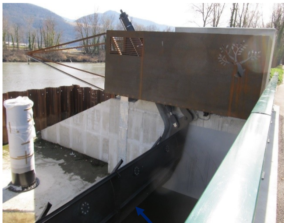
vanne batardeau hydro-pilotée .
